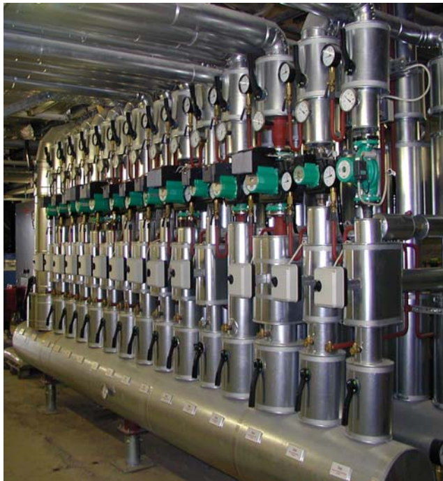
Abbildung 4: Energiesparmaßnahmen am Wärmeverteiler in der Heizzentrale in Herrenberg
