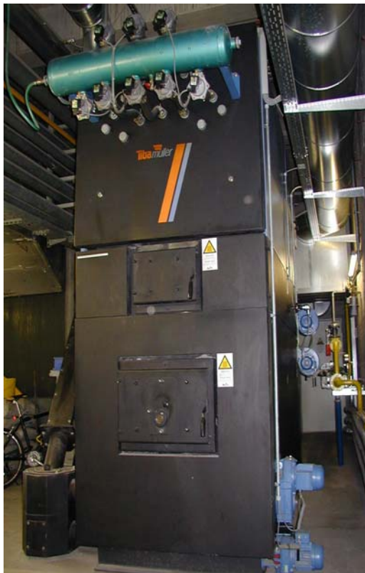
Abbildung 3: Der neue Holzessel in der Heizzentrale in Herrenberg
