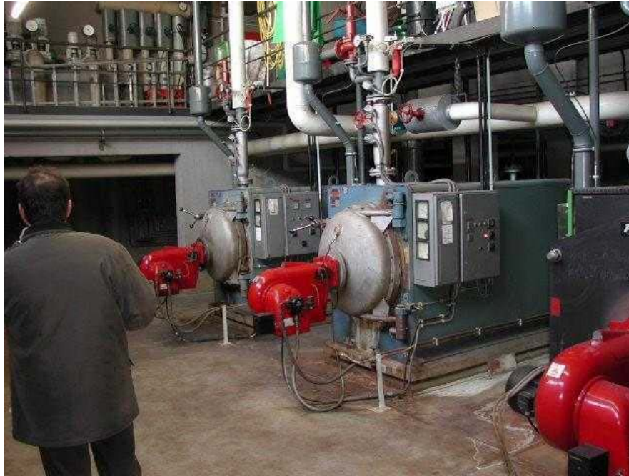
Abbildung 5: Alte Heizzentrale in der Hohbergschule in Plüderhausen
