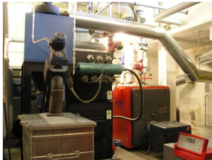
Der neue Heizkessel in der Gerlinger Breitwiesenschule reduziert die Abhängigkeit von fossiler Energie.
